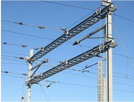
Die Oberleitung der Schweizer Bahnen mit einer Spannvorrichtung
